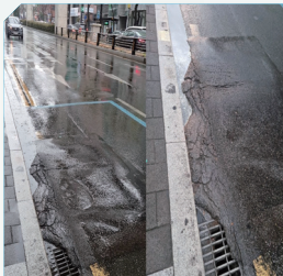
버스 승강장 도로 빗물 고임 문제 개선 (수성시장네거리1 정류장)
