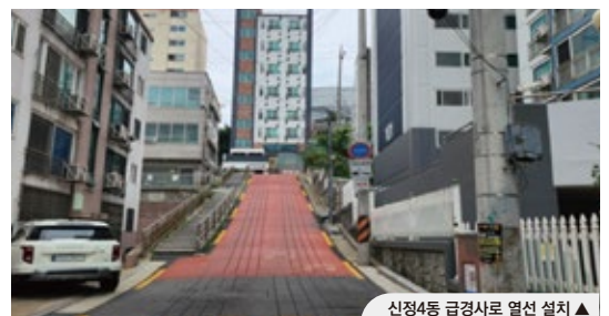
신정4동 급경사로 열선 설치 ▲
